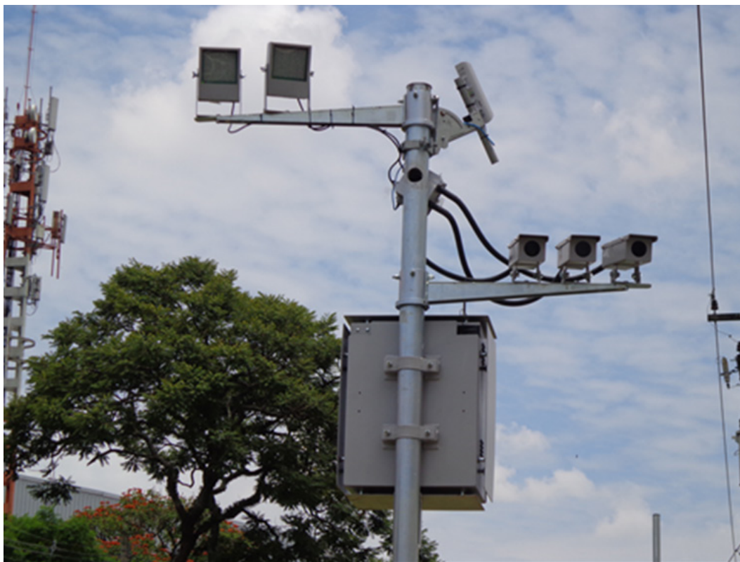
Figura 3.2 – Sistema fixo: câmeras, iluminadores, gabinete, antena.
